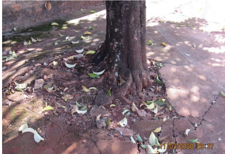
Imagem 6 – Raízes com Afloramento Superficial e Rompimento de Calçada
